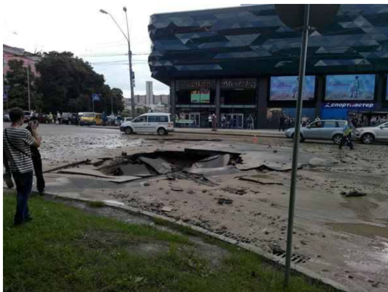
Рисунок 3.1 Пример провала проезжей части дороги из-за гидравлического удара
