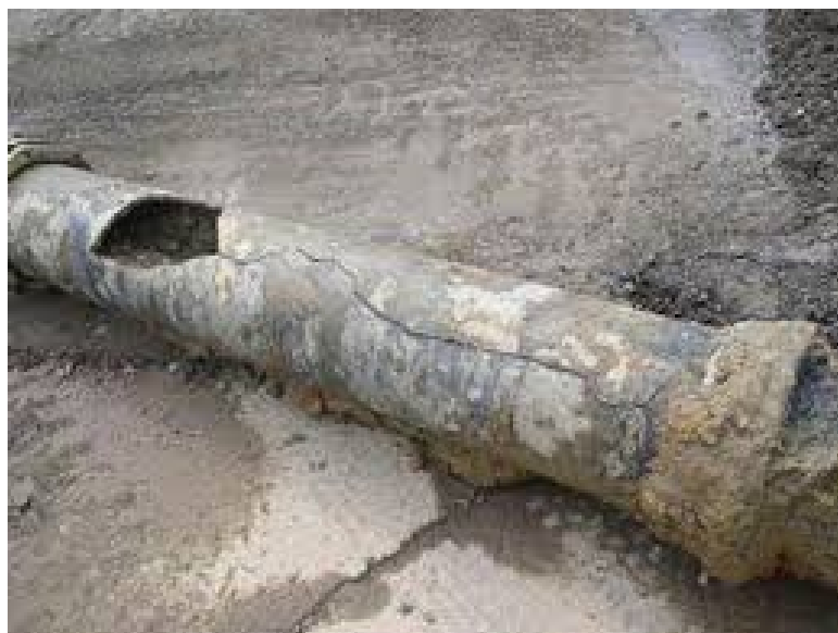
Рисунок 3.3. Пример разрушения трубы большого диаметра из-за гидравлического удара
