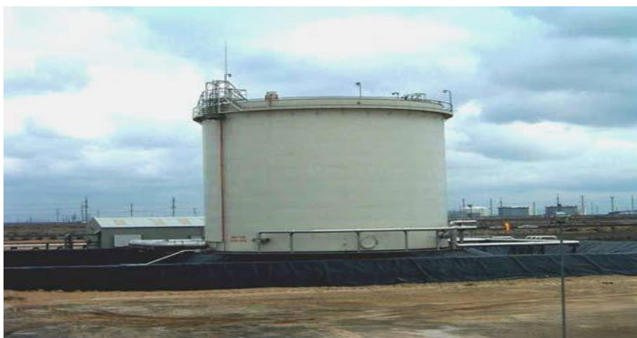
5 Сурет – ННЭ 1\2 Т-1551 мұнайды сақтау резервуары
