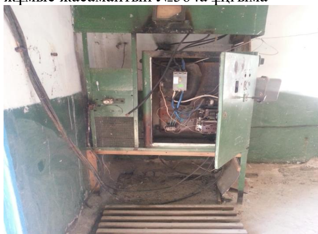
Электроқалқан (жұмыс істемейді)
