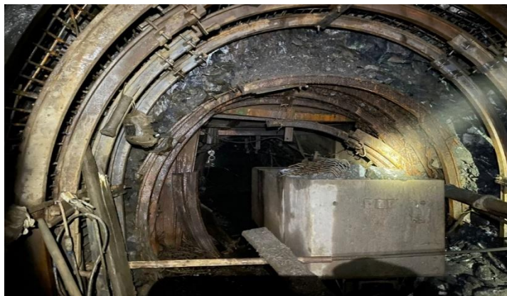
Рисунок 3.6 – Деформации откаточного орта под влиянием очистных работ (гор +0)
