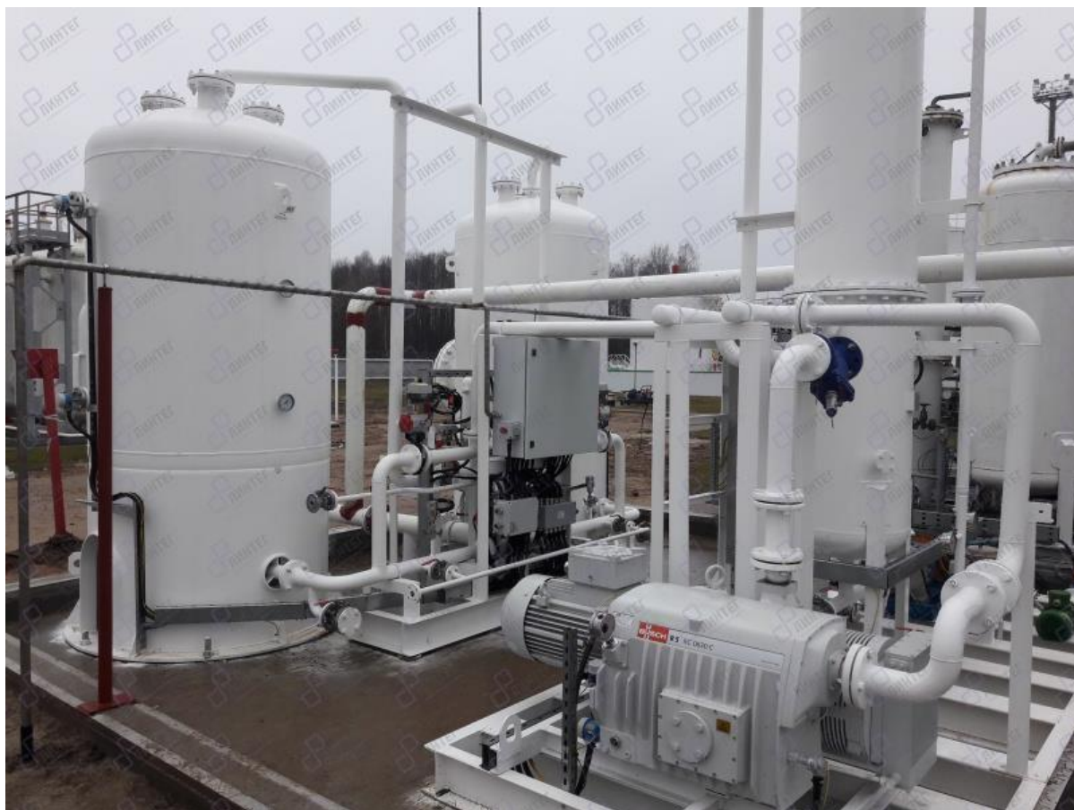
Рисунок 26 – Установка рекуперации нефти
