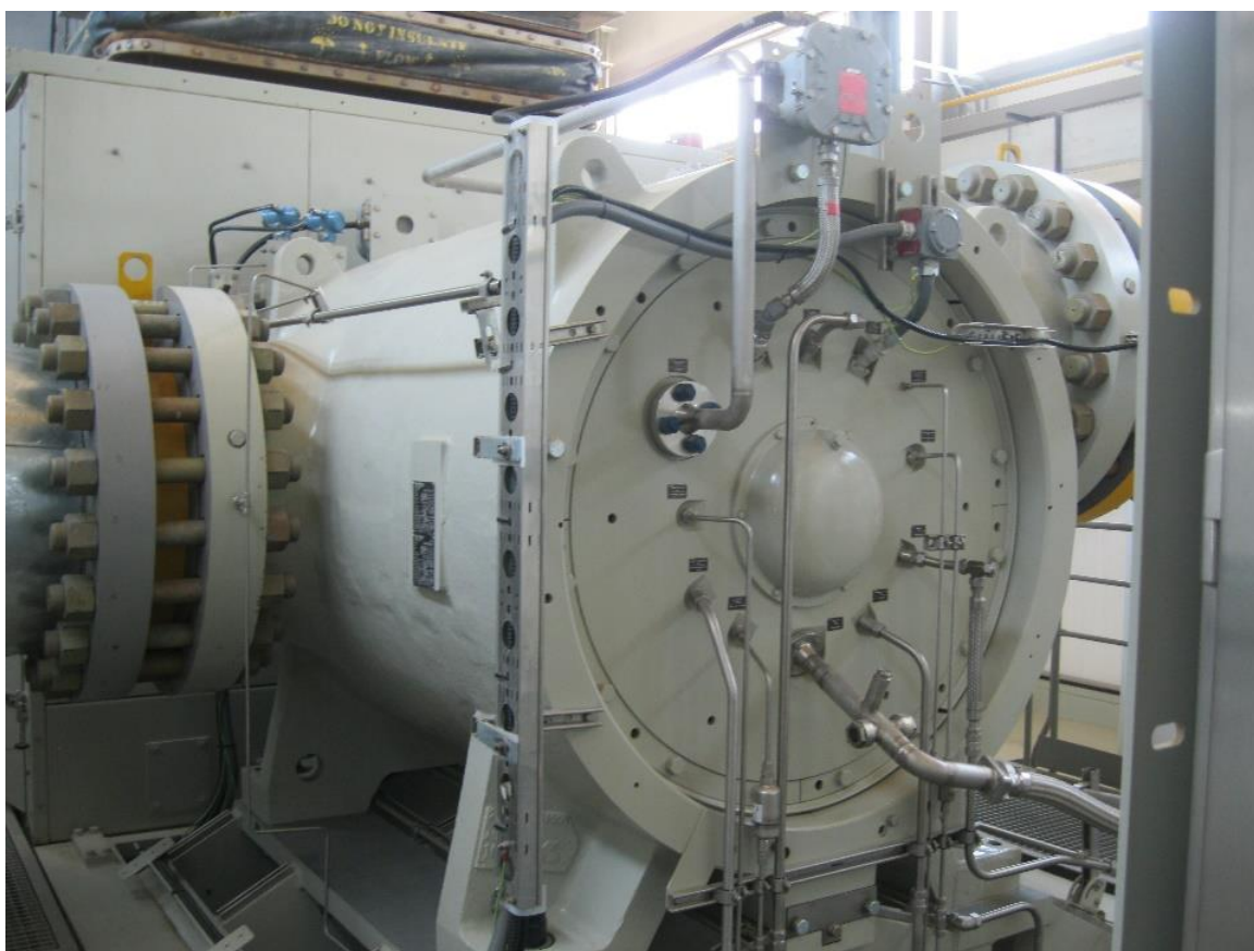
Рисунок 5.15 – Центробежный нагнетатель С652 компании Solar Turbines
