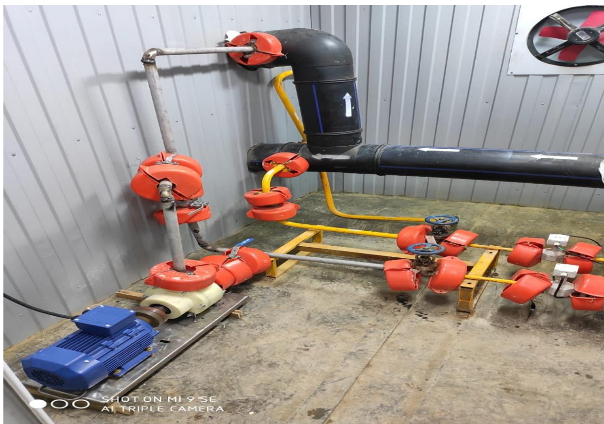
Рисунок 3.13 – Активатор с блоком управления, установленный на месторождении «Центральный Мынкудык»
