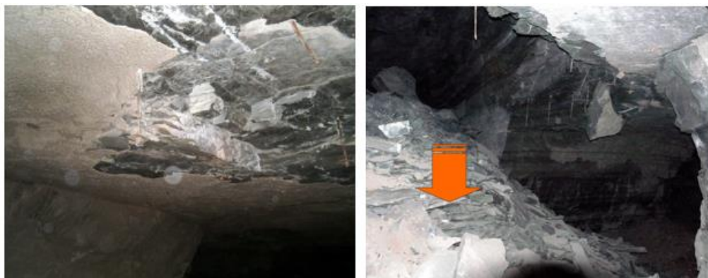
Рисунок 4.13 – Обрушение кровли висячего бока и образование свежих поверхностей на кровле
