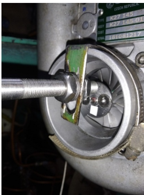
Рисунок 44 – Датчик ДМ-01, закреплённый на корпусе турбокомпрессора с помощью струбины
