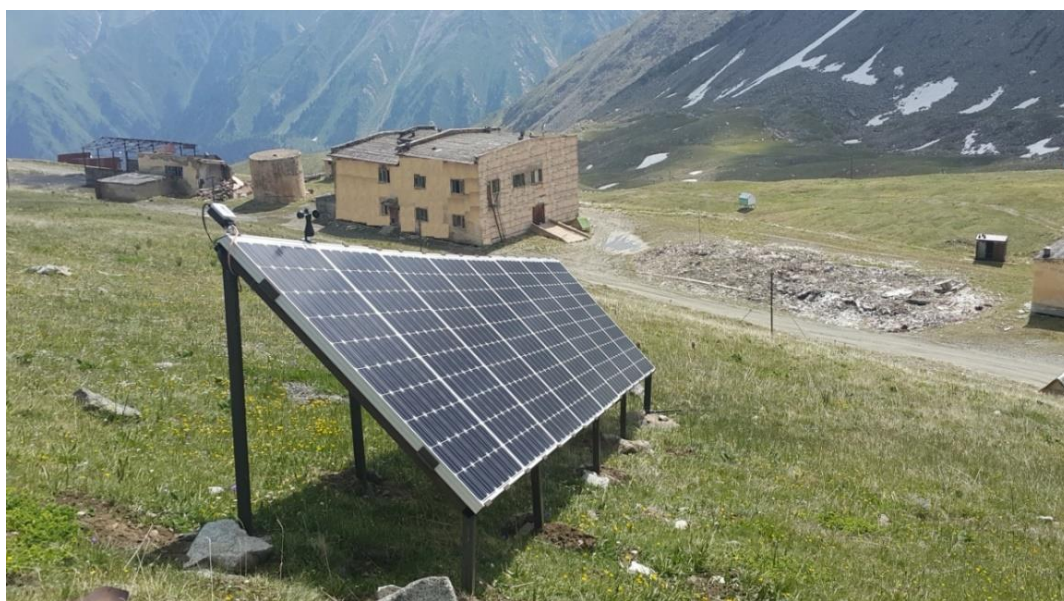
Рис. 3. Установленные восемь солнечных модулей на ТШВНС
